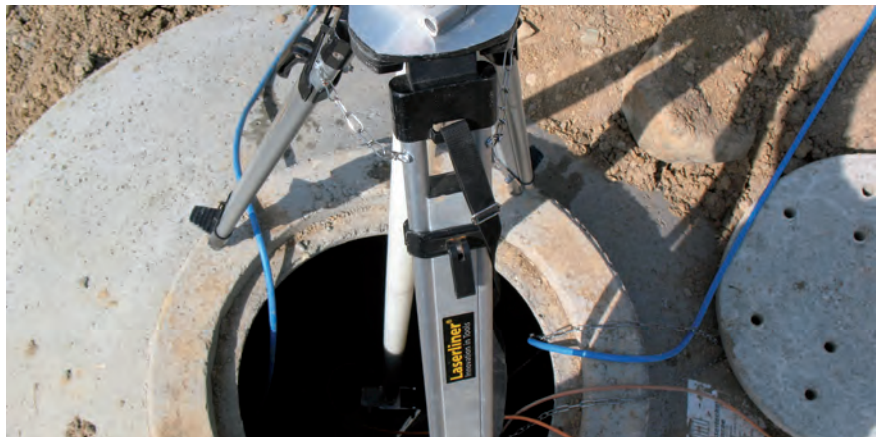
Eine professionelle Ausrüstung – u.a. um Wasserstandsänderungen auf zehntel Millimeter genau erfassen zu können – ist Voraussetzung für zuverlässige Dichtheitsprüfungen.
