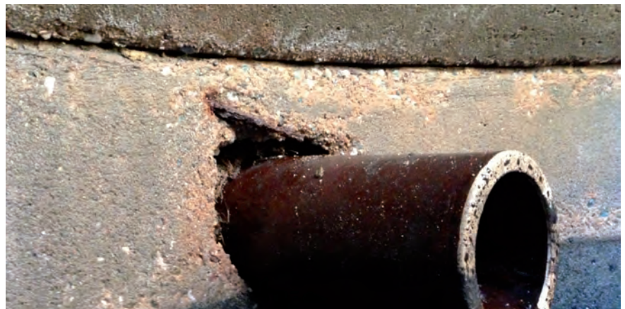
In bruchraue Öffnungen eingemörtelte Rohre sind eine typische Ursache für Leckagen.
