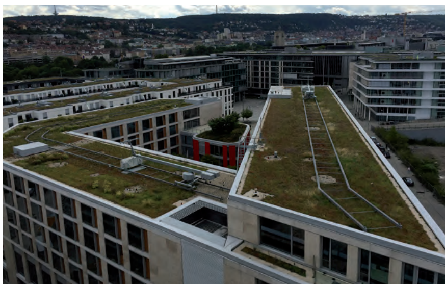
Auf den Gründächern der umliegenden Gebäude wird das Regenwasser gesammelt
