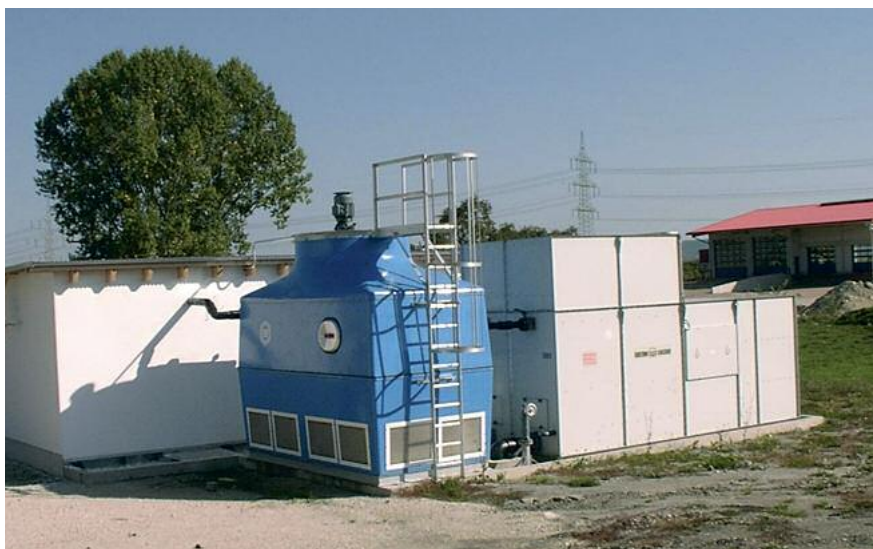
Wasserzisterne 400 m³ Inhalt (im Boden) mit 2 Kühltürmen und Steuerzentrale
